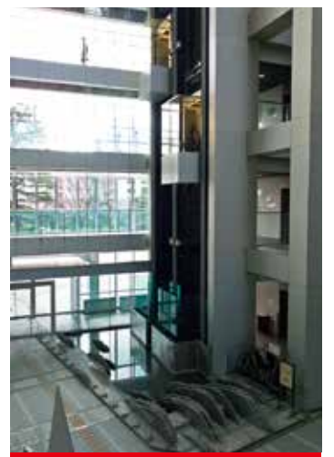
市役所本庁舎のエレベーター
